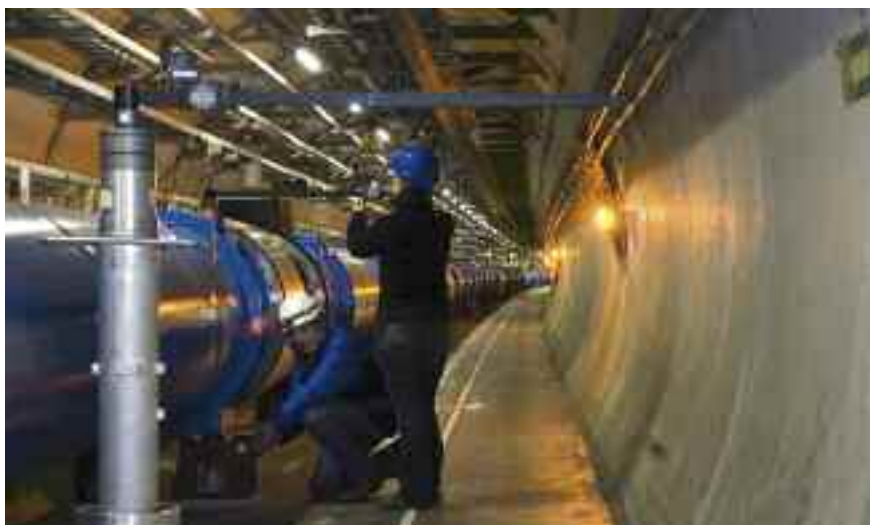
Un par de ingenieros alinean los imanes superconductores en el túnel del LHC (CERN).
